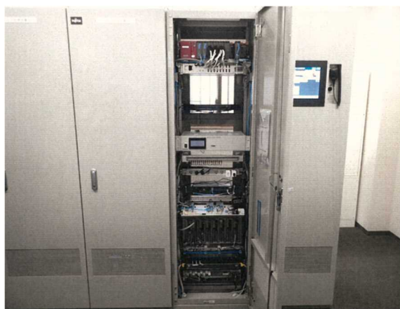
【ダム管理用制御処理設備】
