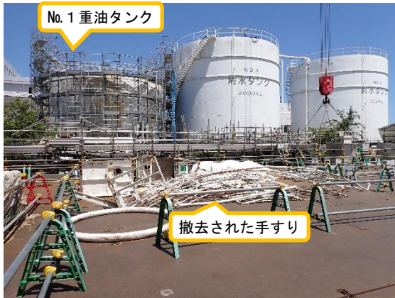
(写真3) タンクから撤去された手すり等の仮置き状況 (南側から撮影)
