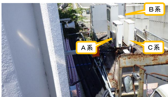
(写真4-2) 炉注水ポンプ電源盤の設置状況
