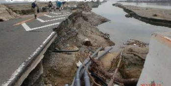
被災状況 (松川大洲地区海岸)
