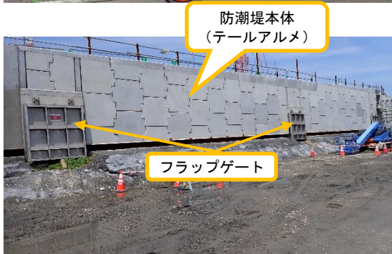
(写真 3) フラップゲートの設置例 (防潮堤本体海側を南東側から撮影)
