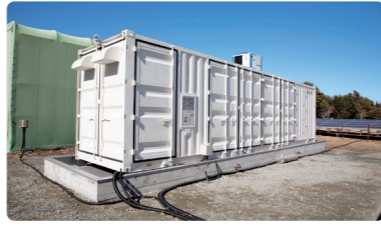
LEシステム浪江工場 40ft コンテナ型RFB システム
