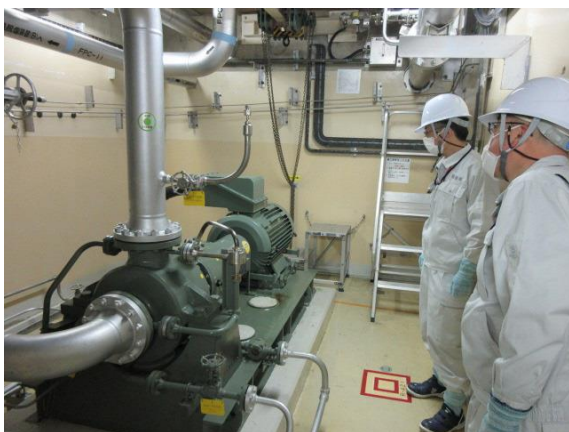
(写真 1) 冷却水ポンプの状況
