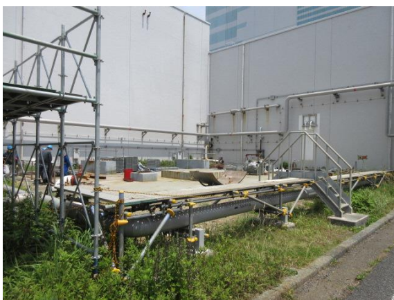
(写真 2) 窒素供給装置の状況
