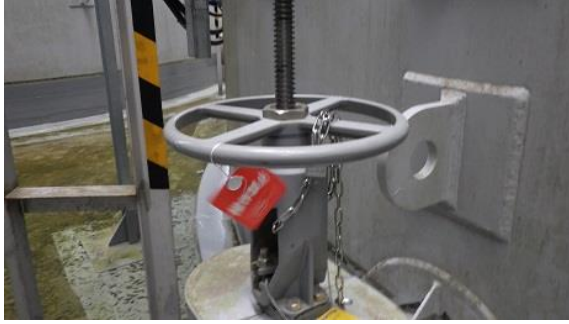
(写真 3 - 3) タンク連結弁操作ハンドルの施錠状 況
