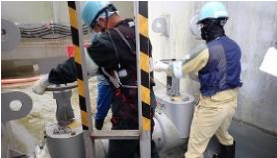
(写真2) タンク連結弁の操作状況
