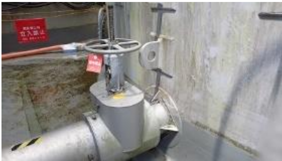
(写真3-1) タンク連結弁への操作禁止札の取り 付け状況①
