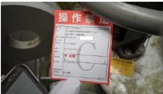
(写真3-2) タンク連結弁への操作禁止札の取り 付け状況②
