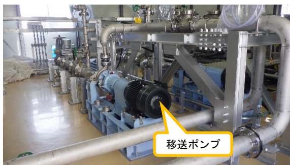
(写真1-3) 多核種移送設備建屋に設置されているALPS処理水移送ポンプの外観・据付状況
