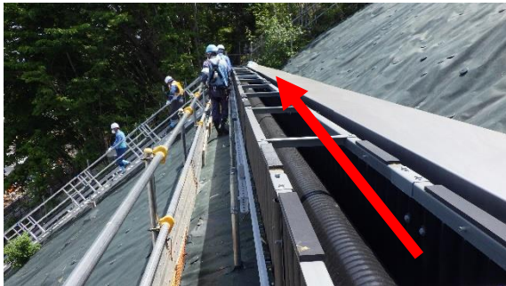
(写真 1 - 6) ALPS 処理水移送配管の外観・据付状況 (矢印：ALPS 処理水の流れ)
