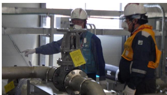
(写真1-1) 移送設備の外観・据付検査状況 (多核種移送設備建屋内)
