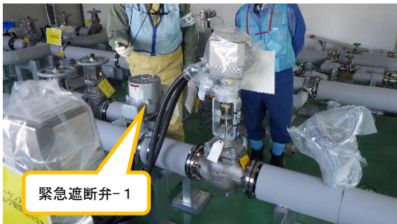
(写真 2 - 1) 緊急遮断弁-1 (5, 6 号機東側電気品建屋内) の検査の状況 ・ストップウォッチを用い、緊急遮断弁-1 が基準時間内に「閉」動作するかどうかについて検査が実施された。
