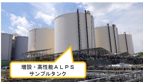
(写真1-2) 増設・高性能ALPSサンプルタンクの外観 (北東側から撮影)
