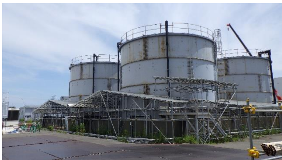
(写真1-3) 既設ALPSサンプルタンクの外観 (南西側から撮影)
