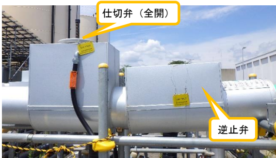
(写真 5) 増設ALPS処理水移送配管との連 結仕切弁等の状況 (東側から撮影)
