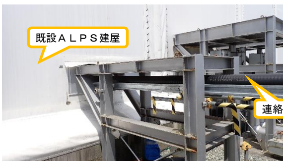
(写真2-1) 既設ALPS処理水連絡配管の状況 ① (既設ALPS建屋出口) (南東側から撮影)
