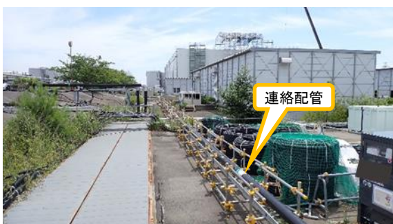
(写真2-2) 既設ALPS処理水連絡配管の状況 ② (地上部の敷設例) (西側から撮影)
