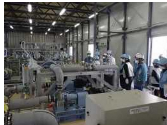
ALPS処理水移送設備をご覧いただいている様子
