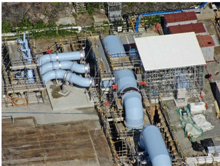
海水移送配管と海水配管ヘッド
