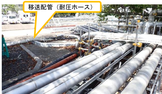
(写真 3 - 1) 移送配管(耐圧ホース)の敷設状況 ① (K 1 南タンクエリア南側付近)
