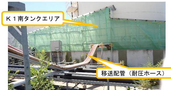
(写真 2 - 2) K 1 北タンクエリアからK 1 南タンクエリアへの移送配管(耐圧ホース)の状況
