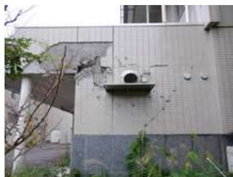
タイル浮き・クラック・剥離
