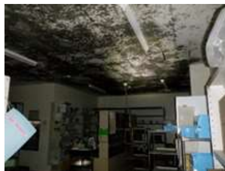
内壁・天井カビ発生
