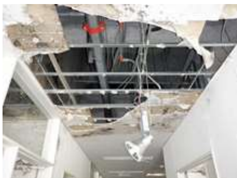
天井漏水跡、仕上材剥離
