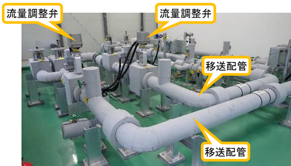
(写真 1 - 1) 5・6号機東側電気品建屋内の移送配管及び各弁等の状況① (北西側から撮影)
