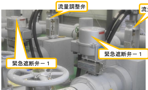
(写真 1 - 2) 5・6号機東側電気品建屋内の移送配管及び各弁等の状況② (北東側から撮影)
