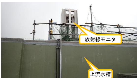
(写真 2) 放流立坑（上流水槽）の放射線モニタ設置状況（南東側から撮影）
