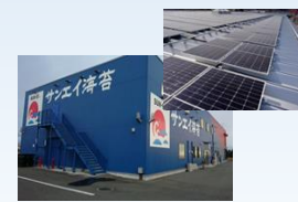
自家消費型再エネ導入事例（㈱サンエイ海苔第二工場）
