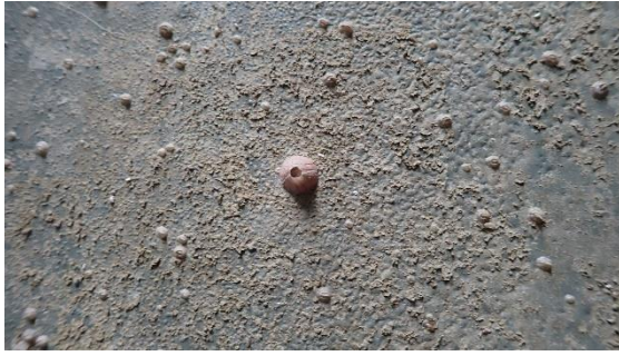
(写真 2 - 2) 上流水槽壁面の状況② (海生生物付着状況)
