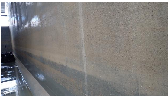
(写真2-1) 上流水槽壁面の状況① (土砂の付着状況)
