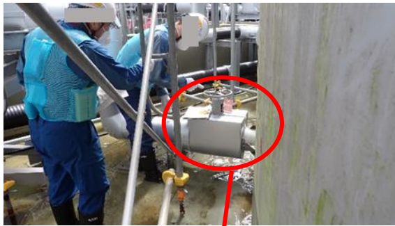
(写真2-1) A群タンク (K4-A1) 出口弁 「全閉」の確認状況
