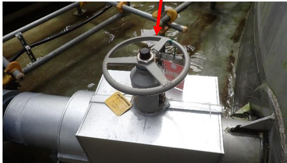
(写真2-2) A群タンク (K4-A1) 出口弁 「全閉」の状況
