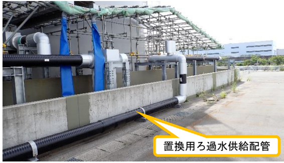
(写真1-2) 置換用ろ過水供給配管の敷設状況 (北西側から撮影)
