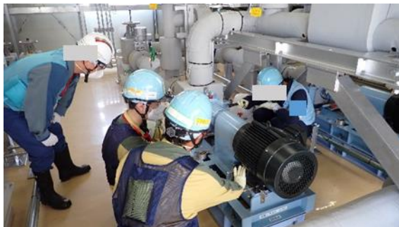
(写真2-3) 稼働後の処理水移送ポンプの確認状況
