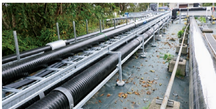
ALPS処理水移送配管
