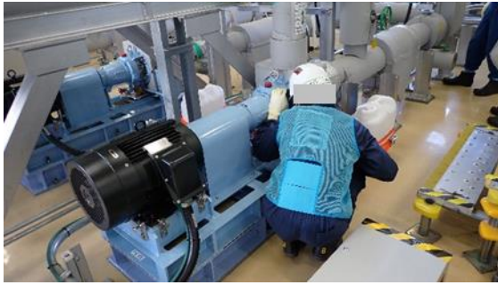
(写真 2 - 1) 処理水移送ポンプ (B) の稼働状況 確認の状況
