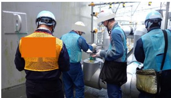
(写真1-1) 連結弁の状態確認の状況
