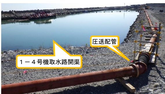
(写真1-4) 圧送配管
