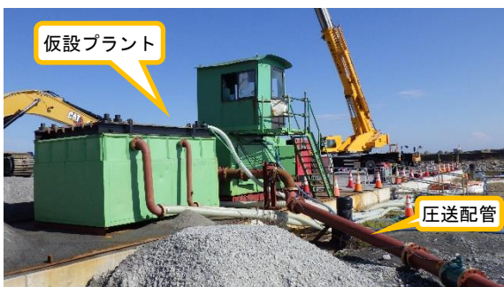
(写真1-2) メガフロートに設置されている仮設プラント①
