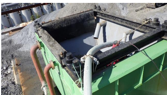
(写真1-3) メガフロートに設置されている仮設プラント② (当該槽内で海水と砂を混同する。)
