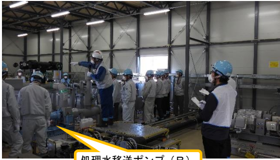
処理水移送ポンプ（B）
