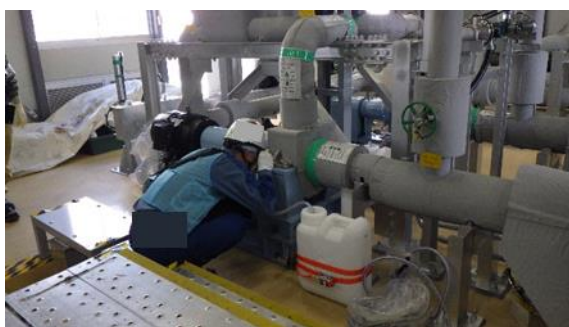
(写真2-1) 稼働前の処理水移送ポンプの確認状 況
