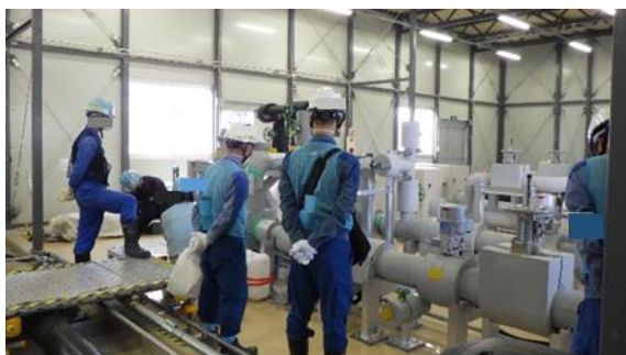
(写真2-2) 稼働後の処理水移送ポンプの確認状 況
