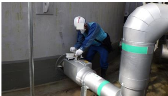
(写真1-3) C群タンク (K4-C1) 出口弁 「全閉」の確認状況
