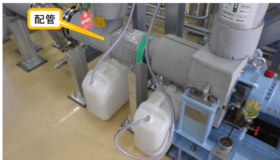
(写真 7-2) 空気と共に排出された水を回収する ポリタンク
