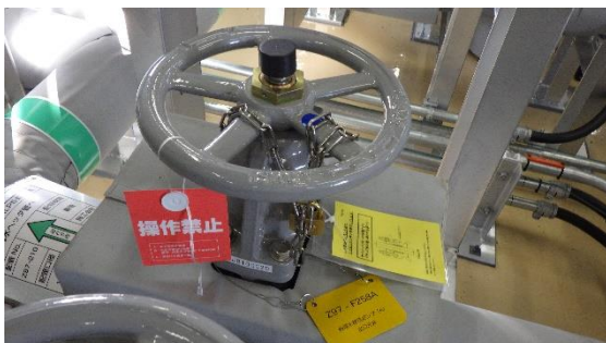
(写真2) 「全閉」操作された弁の一例
