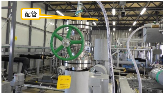
(写真 7-1) 処理水移送配管内の空気を除去する 配管
