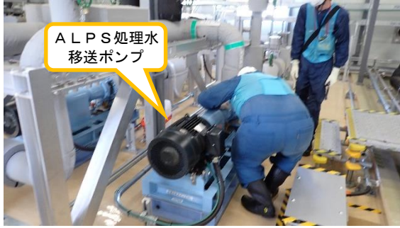
(写真 2 - 1) ALPS 処理水移送ポンプ
