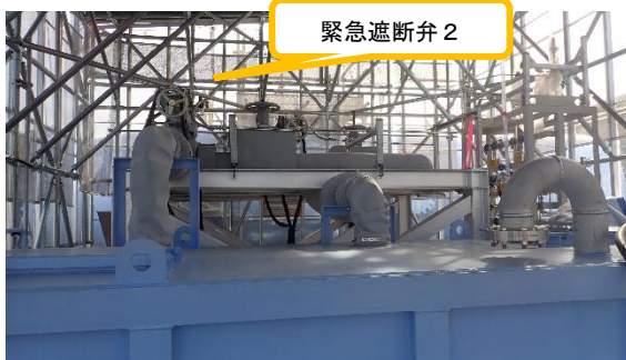
(写真 3 - 2) 緊急遮断弁 2
