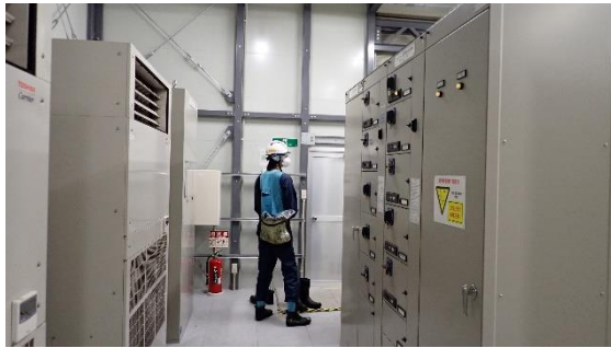
(写真 2 - 2) ALPS 処理水移送設備に係る電源 盤等
