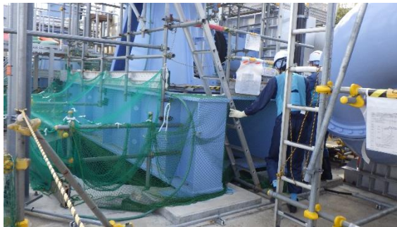
(写真 3 - 1) 海水移送ポンプ
