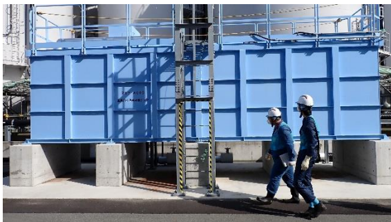
(写真1-2) 置換用ろ過水供給タンク
