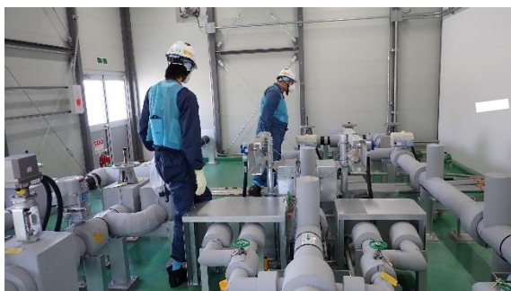
(写真4) バルブユニット
