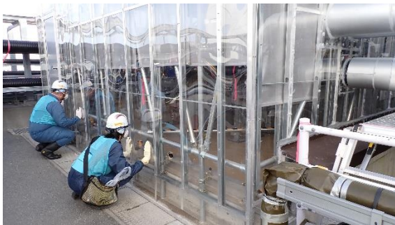
(写真1-3) 屋外受入バルブユニット
