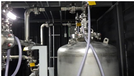
(写真 2 - 4) 脱塩装置の状況
