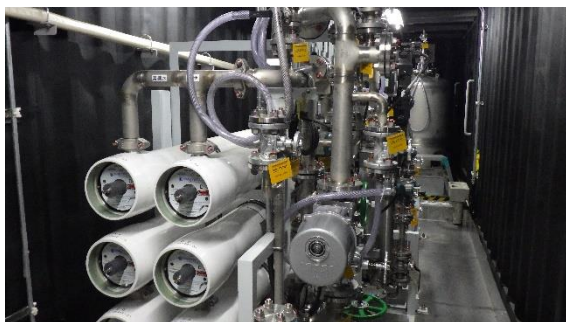
(写真2-2) モバイルRO装置の状況
