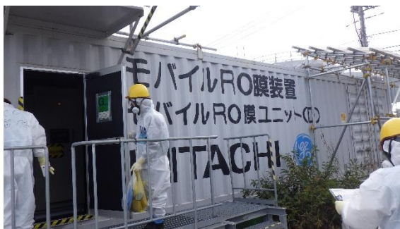
(写真2-1) モバイルRO膜装置コンテナの外観
