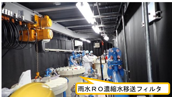
(写真 3) 雨水RO濃縮水移送フィルタの状況
