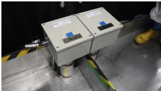
(写真 2 - 5) 漏えい検知器
