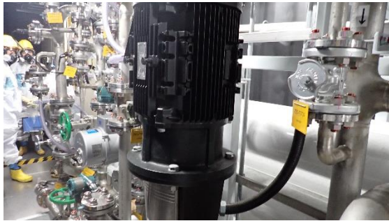
(写真 2 - 3) 加圧ポンプの状況
