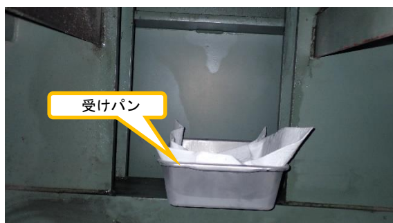
(写真3) 5号機R/B排風機 (A) 軸受け下 部に設置された受けパン
