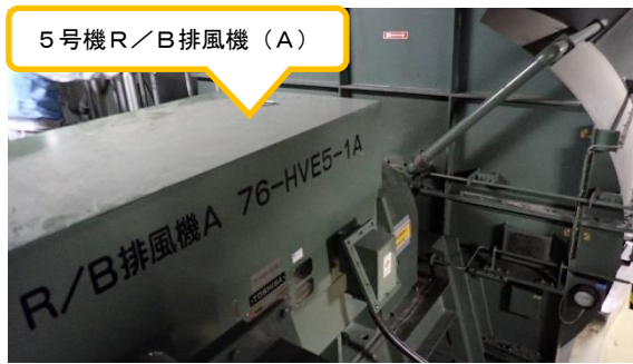
(写真1-1) 5号機R/B排風機 (A) の状況 (北東側から撮影)
