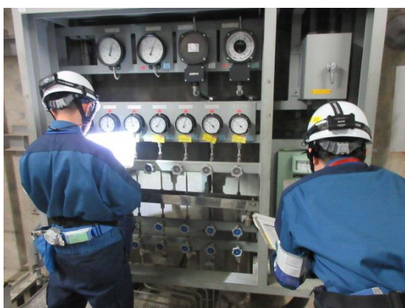
(写真 2 - 1) 起動後に計器を確認している状況
