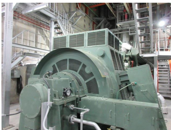
(写真 1 - 2) 発電機の状況
