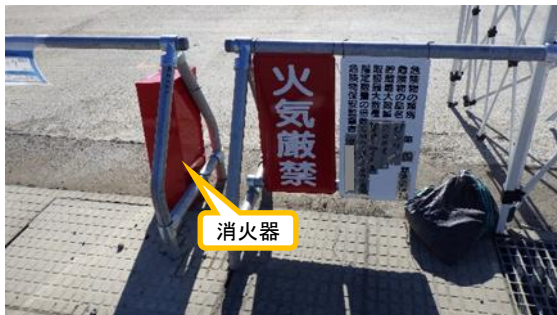
(写真1-1) 道路側の標識掲示及び消火器設置の 状況 (北側から撮影)
