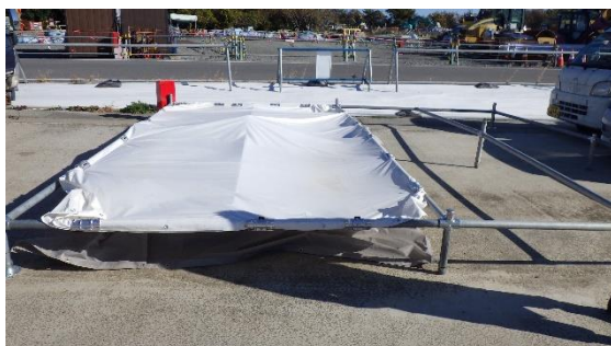
(写真1-2) 凝固を行う設備 (二つ目のシート) の消火器設置の状況 (南西側から撮影)
