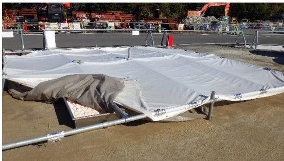
(写真 3 - 1) 凝固を行う設備 (一つ目のシート) の状況 (南西側から撮影)
