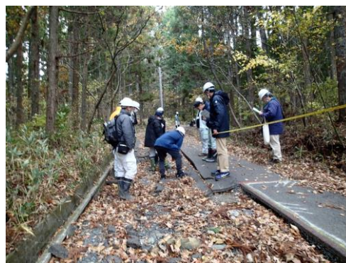
▲ 林道被害の災害査定の様子(田代川平線)
