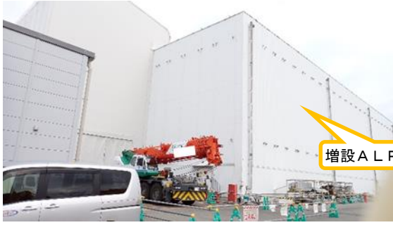
(写真1) 増設ALPS建屋外観 (南西側から撮影)
