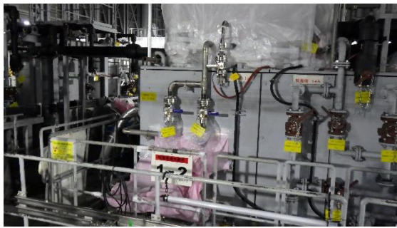
(写真4-3) 増設ALPS (A系) の (写真4-1)、 (写真4-2) と同一箇所の状 況 (南側から撮影)
