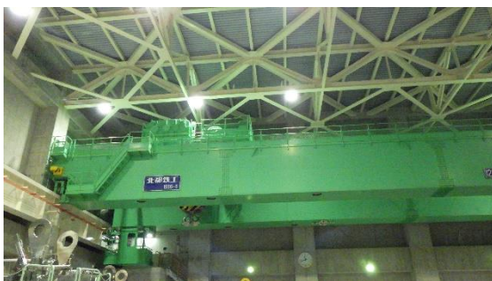
(写真5-4) 共用プールの天井クレーン
