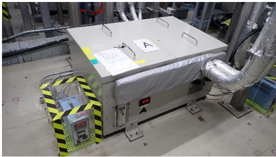
(写真1-4) ダストモニタの設置状況
