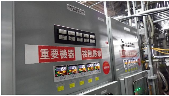
(写真1-3) PCVガス管理設備現場制御盤の設置状況
