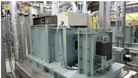
(写真1-5) 希ガス放射線モニタの設置状況
