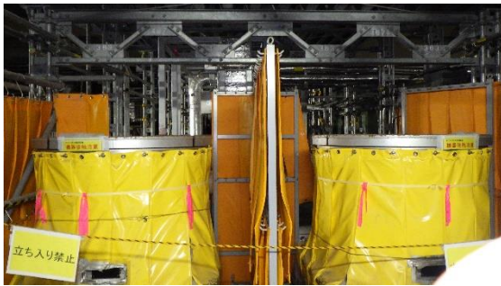
(写真3) フィルタユニットの設置状況
