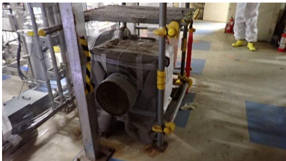
(写真1-2) 塩害対策ハウス用送風機の設置状況
