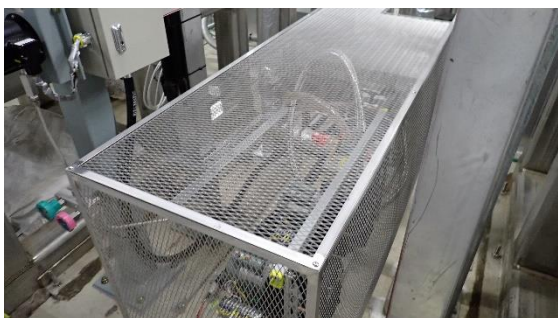
(写真1-6) ダストモニタ吸引ポンプの設置状況
