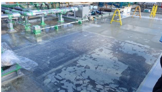
(写真3) 頂版上の防水塗装の状況。写真はプ ライマー（下塗り剤）を塗った状況
