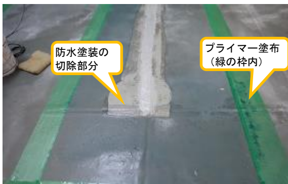
(写真 1 - 1) 防水塗装の状況①
