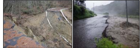
福島吾妻裏磐梯線(レークライン)の被災状況
