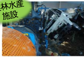
八沢排水機場（相馬市）
