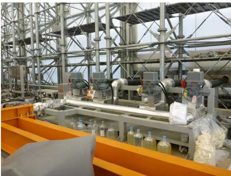
○多核種除去設備 移送配管（屋内）
