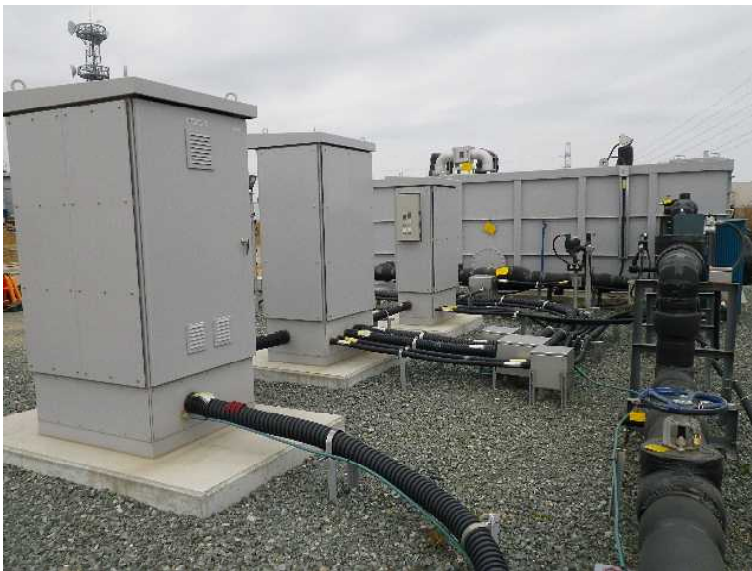
○地下水バイパス 揚水受タンク No.3
