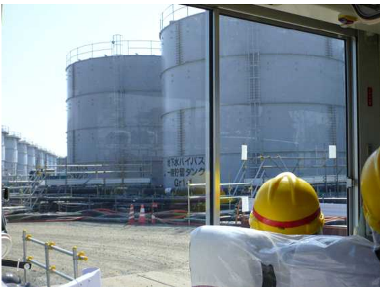
○地下水バイパス 一時貯留タンク
