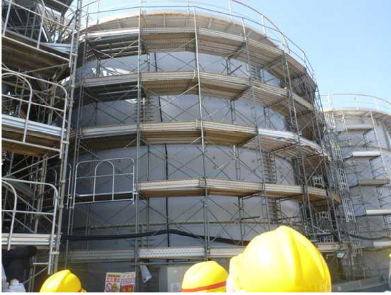
○H6 タンクエリア 汚染水漏えいタンク
