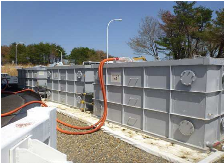
○ろ過水タンク付近に設置 されている雨水移送用の ノッチタンク
