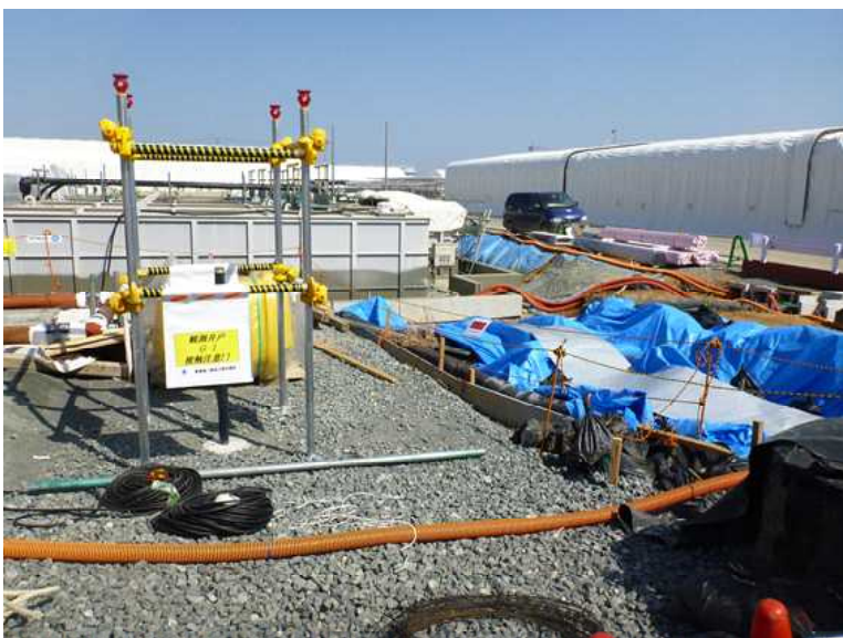
○H6 タンクエリア 地下水観測孔G-1
