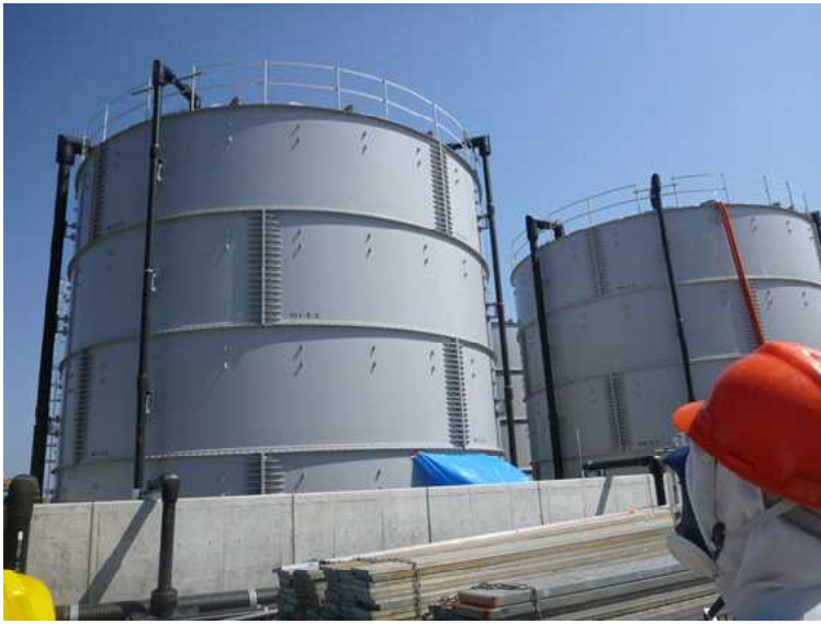
○多核種除去設備 サンプルタンク
