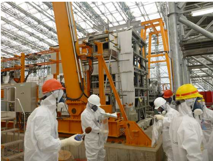
○多核種除去設備C系 クロスフローフィルタ
