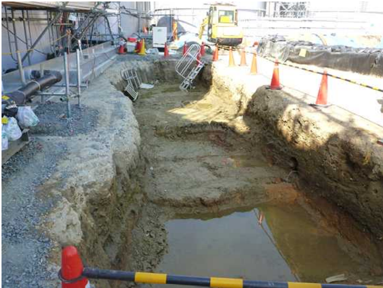
○H6 タンクエリア 汚染水漏えい箇所（汚染土撤去箇所）
