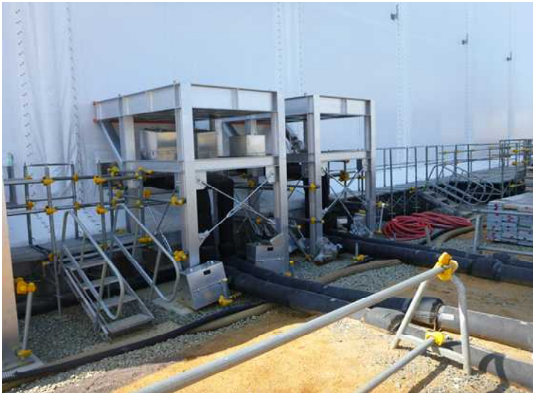
○多核種除去設備 移送配管（屋外）
