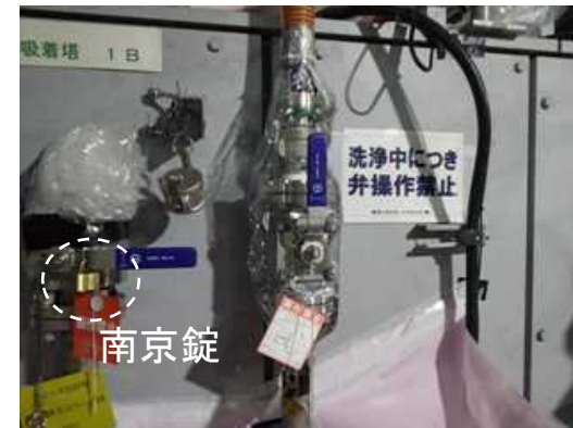
弁のロック状況写真(一例)
