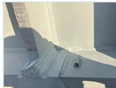
フックが折損し、被災者が落下
