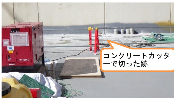
(写真1) 水漏えい箇所直下のコンクリート盤の状況
