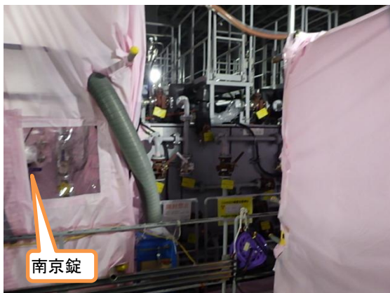
(写真3) 南京錠による弁操作ができない措置（ロック）の状況
