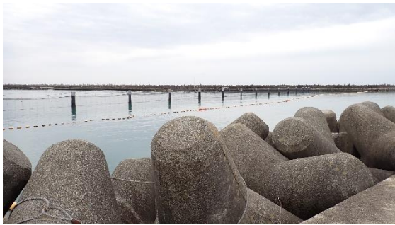
(写真4-1) 本設東波除堤魚類移動防止網の設置 状況①(東波除堤北側から南東方向 を撮影)
