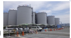
ALPS処理水保管タンク（測定・確認用設備）
