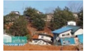
家屋被害：福島市
