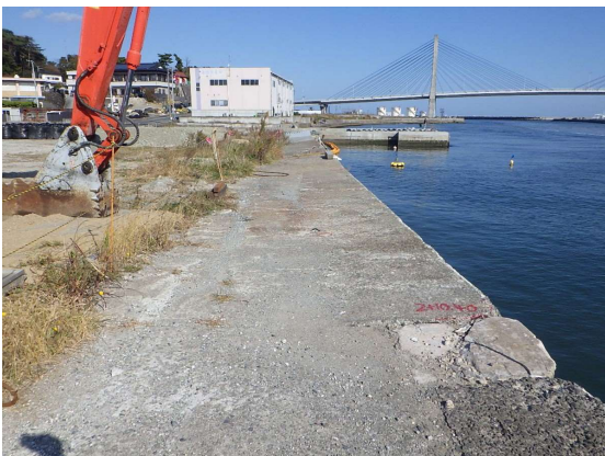
護岸（H-2） 復旧前
