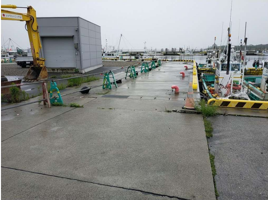
岸壁（I-3） 復旧前
