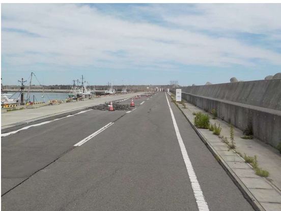
臨港道路（M-22） 復旧前
