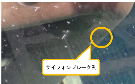
(写真1-2) 南側に配置されているSFP注水配管のサイフォンブレイク孔の状況 ※水面に不純物(白い物)が浮遊している
