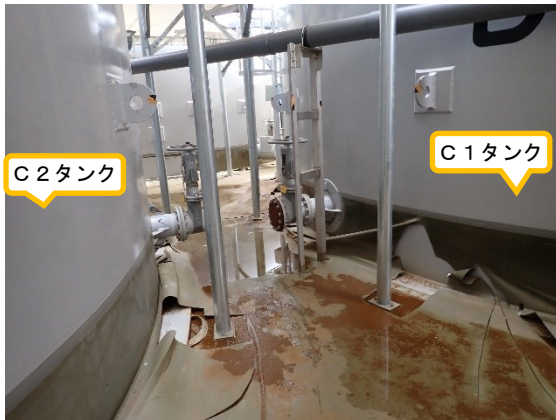
(写真2-2) タンク下部の被覆膜の剥がれや 堰床面の被覆膜に捲れた箇所 の一例②
