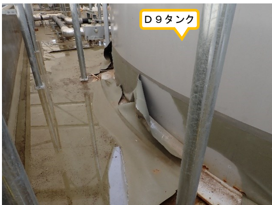
(写真2-1) タンク下部の被覆膜の剥がれや 堰床面の被覆膜に捲れた箇所 の一例①
