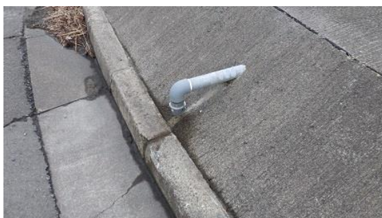
(写真2-1) 水が溢れ出た配管
