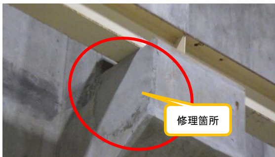
(写真3-3) 天井クレーンガーター受けの修理箇所② (写真3-2 拡大)
