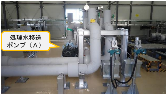
(写真3) 処理水移送ポンプ (A) の稼働状況
