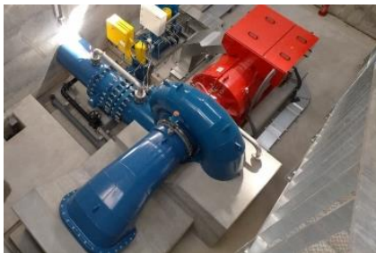
【信夫山・光大寺小水力発電所 水車発電機（令和4年度）】
