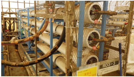
(写真1-3) 逆浸透膜の処理ユニット ※淡水化装置RO3の一部
