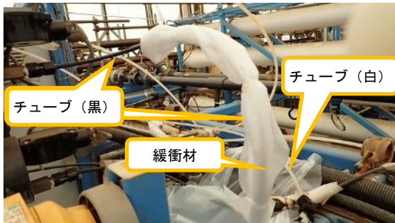
(写真2) 緩衝材の設置状況 ※漏えい発生時、チューブ(黒)と チューブ(白)が接触していた。
