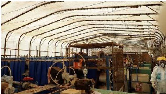
(写真1-2) 淡水化装置RO3建屋内部
