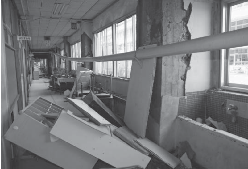
(被災状況 第一小学校校舎内)
