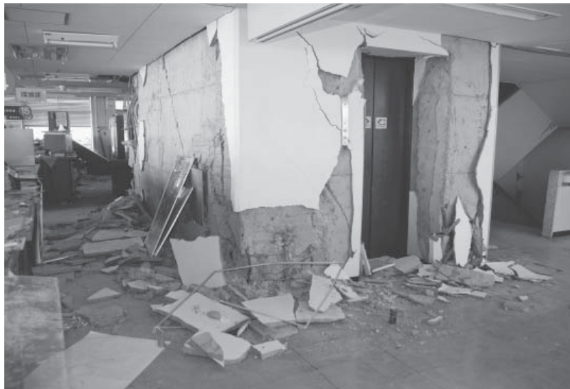
(被災状況 市庁舎内〈2階〉)
