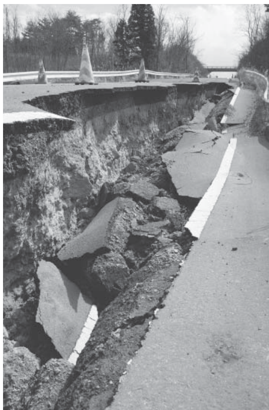
(道路の被災状況 松塚地内)
