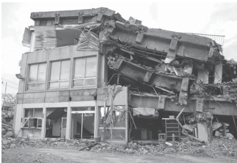
(被災状況 市内製造業社屋)
