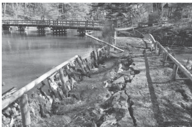
(被災状況 牡丹園内)
