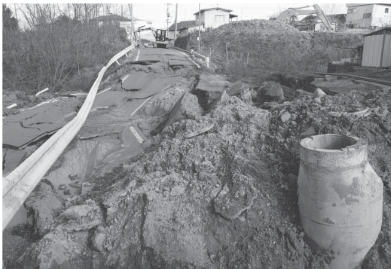
(道路の被災状況 緑町地内)
